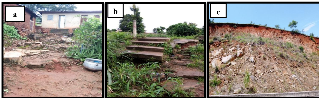
Photo 1. Actions de l'érosion dans la zone d'étude
