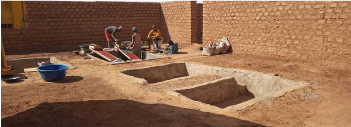
Figure 6: Piscines de traitement de l'or à Gidan Daka
